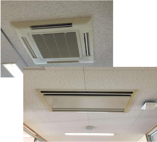
○全教室、特別教室、廊下にもエアコンが設置されています。
